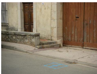
Fuite secteur 5 située 6 Avenue de la libération.
