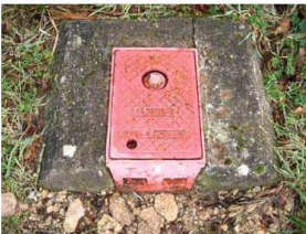
Bouche de lavage fermée
