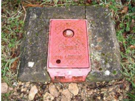
Bouche de lavage fermée
