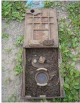
Bouche Incendie de 80 mm à tenons
