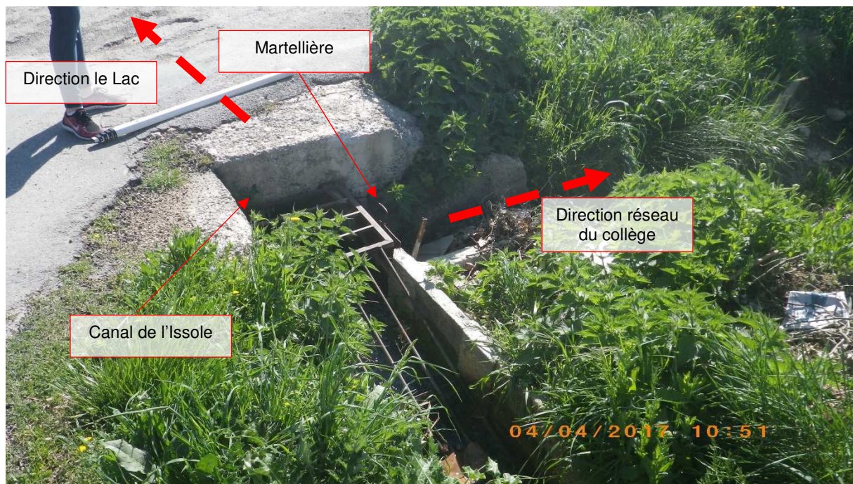
Figure 32 : Photographie de la zone posant un problème d'évacuation des débits
